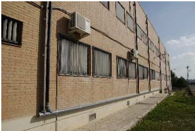
Detalle de las tuberías de recogida de aguas pluviales conectadas al sistema. En la primera de ellas se aportan aguas de los lavabos de alumnas.
