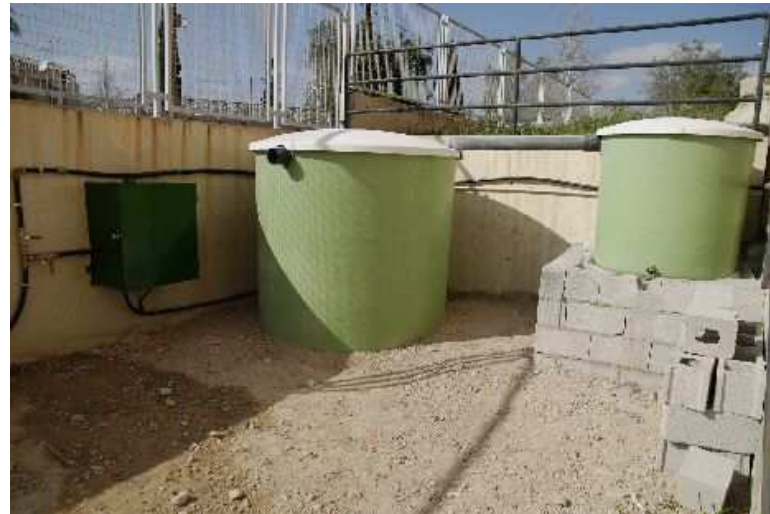
Los dos depósitos combinados y, en la pared del muro, sistema de motobomba.
